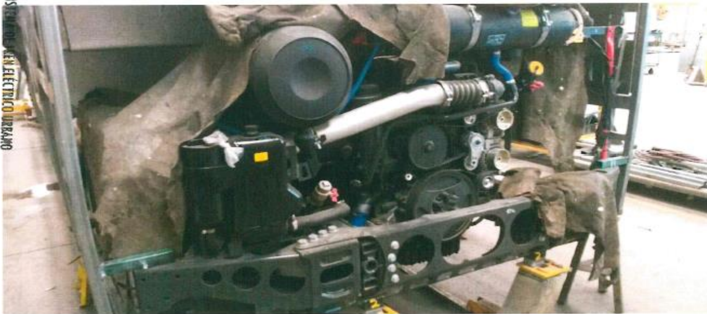
Montaje de motor
