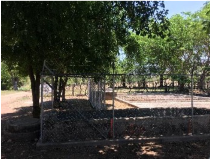
Planta de Tratamiento de Aguas Residuales en la localidad de La Labor, municipio de Ejutla.
