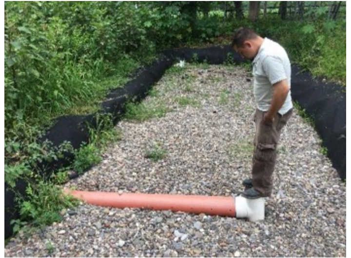
Humedal de la Planta de Tratamiento de Aguas Residuales en la localidad de La Labor, municipio de Ejutla.
