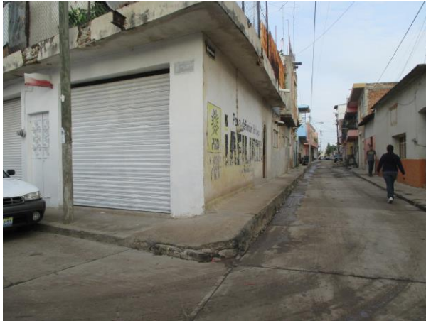
IMAGEN QUE EXPRESA LAS CONDICIONES FISICAS EN REGULAR ESTADO DEL PAVIMENTO EN LA VIALIDAD/VP NACIONAL-OTE Y GUERRERO.
