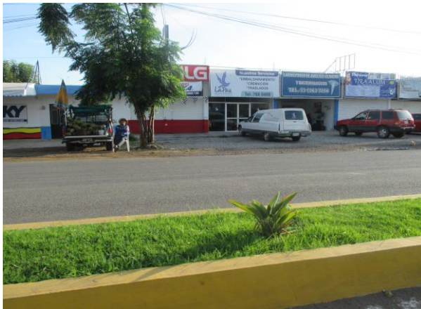
IMAGEN QUE EXPRESA LAS CONDICIONES FISICAS EN BUEN ESTADO DEL PAVIMENTO EN LA VIALIDAD/VP NACIONAL.
