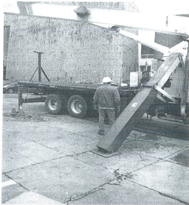
Grúa lista para realizar maniobras de carga y descarga de transformadores a la subestación eléctrica
