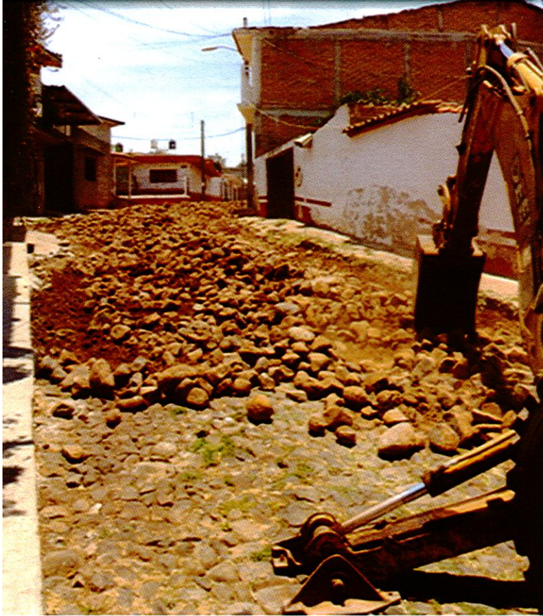
EMPEDRADO AHOGADO EN CONCRETO Y RED DE AGUA POTABLE Y ALCANTARILLADO EN CALLE RICARDO FLORES MAGÓN EN CABECERA MUNICIPAL
