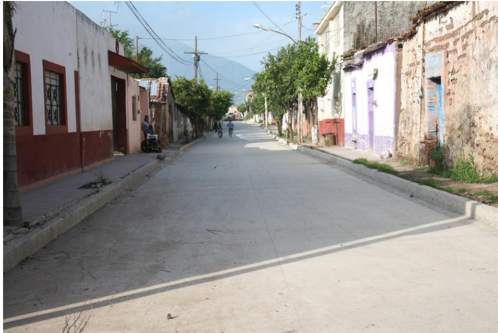
Terminada la pavimentación de la calle Amado Neruo en la Cabecera Municipal
