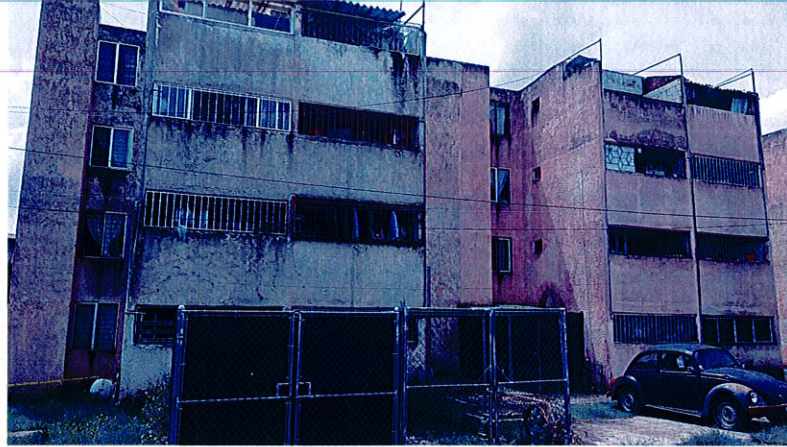
Se mejorará la imagen urbana de 56,000 m2 en la unidad Habitacional Moctezuma en Zapopan, se intervienen 100 edificios.
