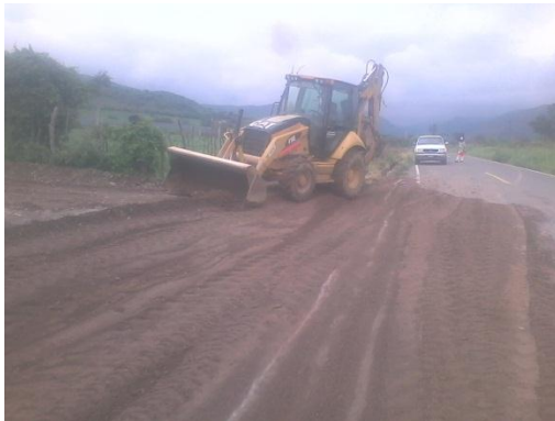
Deslave de tierra en las cercanías del cruce.
