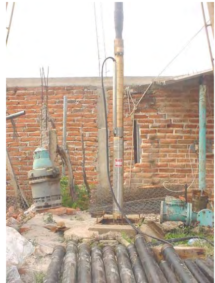
Pozo No. 4 (Equipamiento Bomba Sumergible Acero Inox.)
