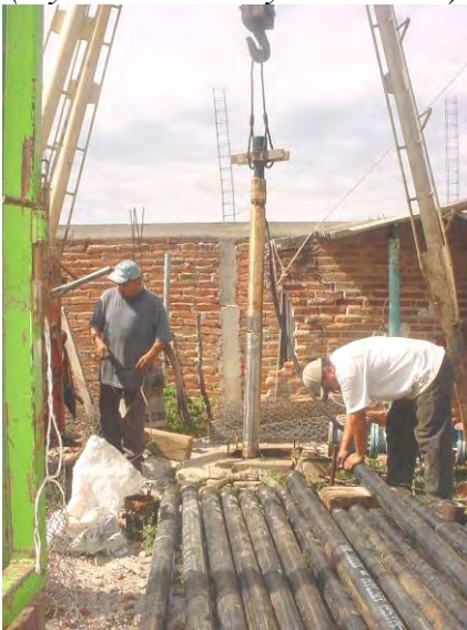
Equipamiento Pozo No. 4 (Saltillo esq. Veracruz).
