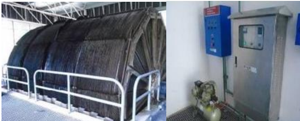
Imágenes: “Cuarto de Bombas y Planta de Tratamiento de Aguas Residuales”.
