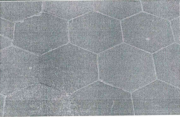
ASENTAMIENTO EN PISOS
